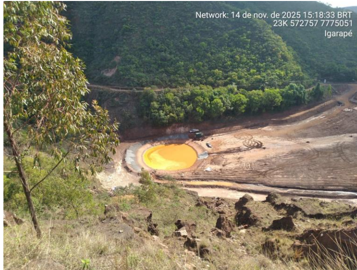
Figura 5.10 - Sump com a manta cimentícia e sistema de bombeamento implementado.
