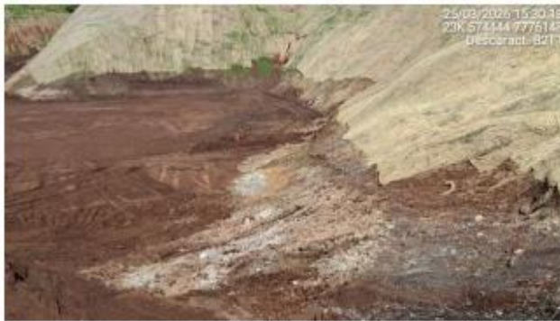
Foto 6.34 - Remoção de camada de rejeito até o contato com o terreno natural.
