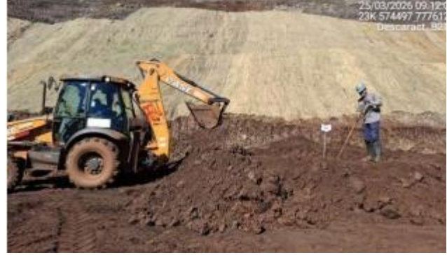
Foto 6.45 - Rebaixamento da instrumentação instalada na região do reservatório.
