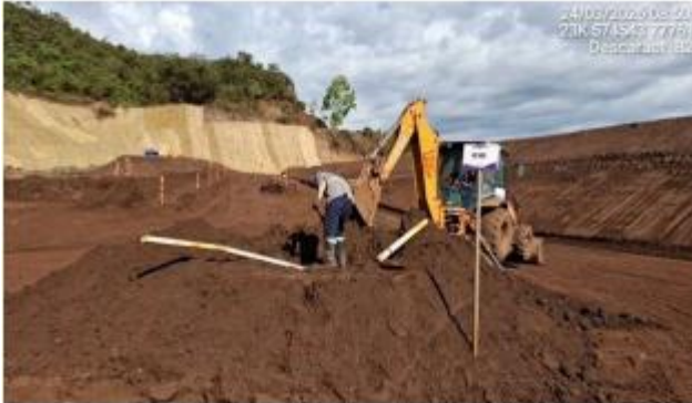
Foto 6.44 - Rebaixamento da instrumentação instalada na região do reservatório.
