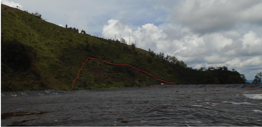
Figura 5.10 – Vista do escorregamento situado na encosta a montante do reservatório.
