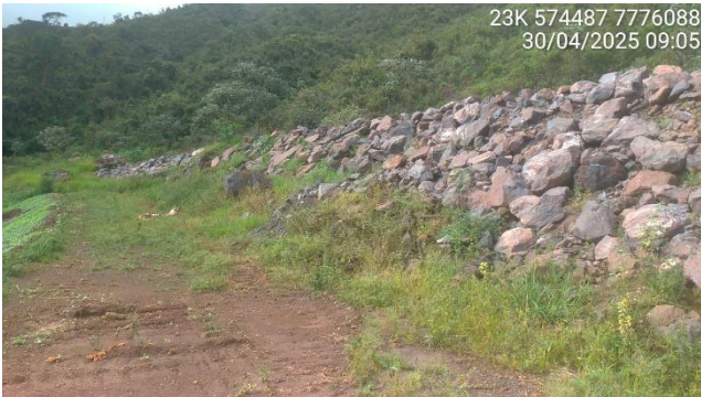
Foto 5.3 – Detalhe da berma de equilíbrio em enrocamento na encosta na margem esquerda.
