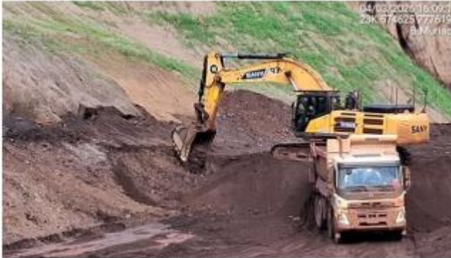
Foto 6.32 – Remoção de camada de rejeito até o contato com o terreno natural.
