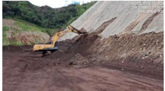
Foto 6.35 - Remoção de camada de rejeito até o contato com o terreno natural.
